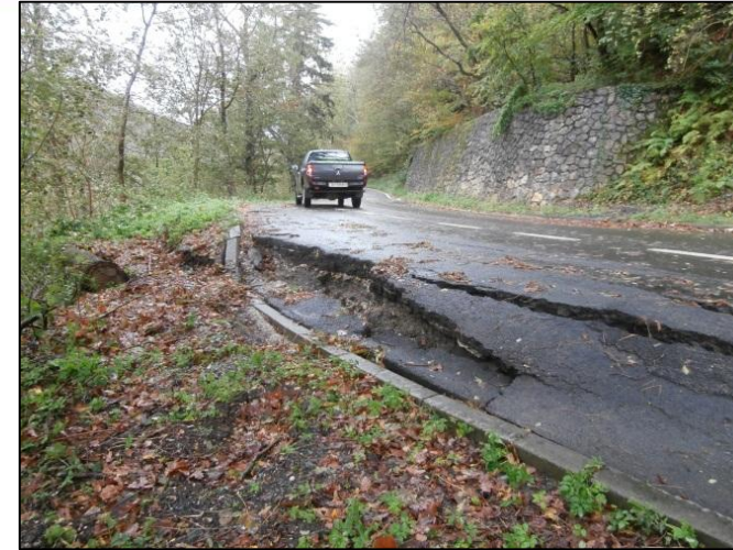
Klizište uz cestu
